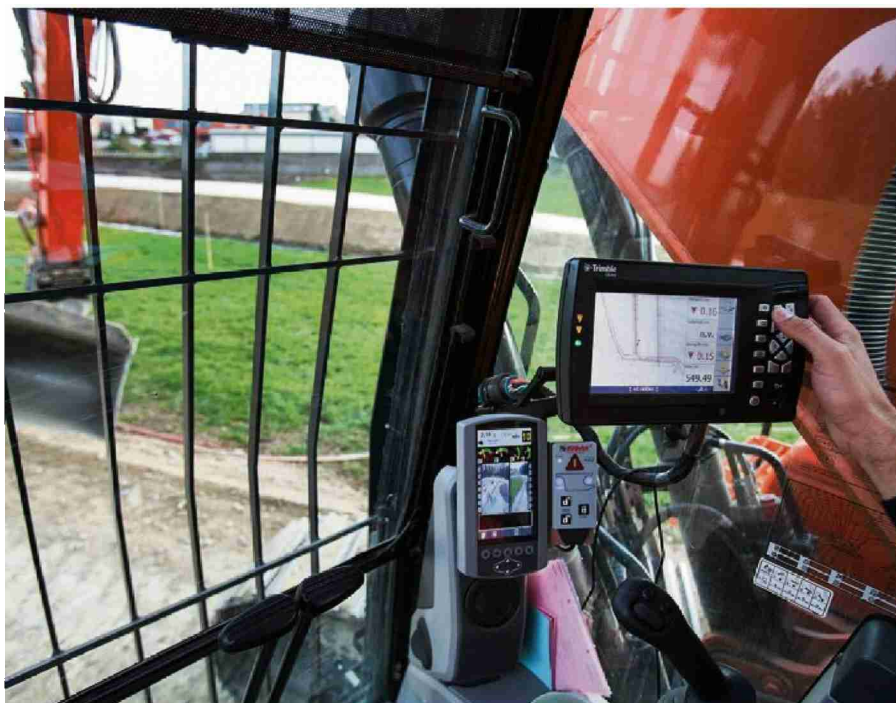
Mithilfe von digitalen Plänen wird auf der Baustelle im Wädenswiler Rütihof zentimetergenau gebaggert.
