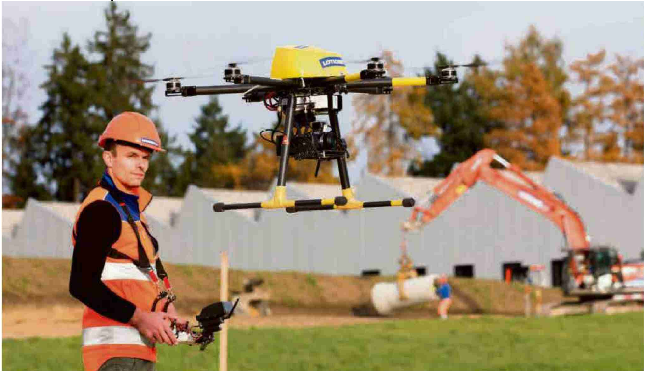
Konstrukteur Raniero Fanger ist bei der Tiefbaufirma Löttscher der Herr der Drohne. Seit zwei Jahren ist das Gerät sein Arbeitsinstrument.
